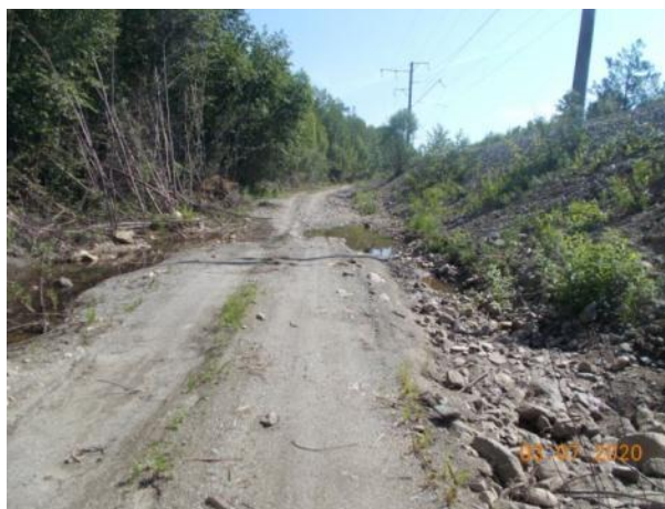
Рисунок 7 – Водоотводная канава на участке
